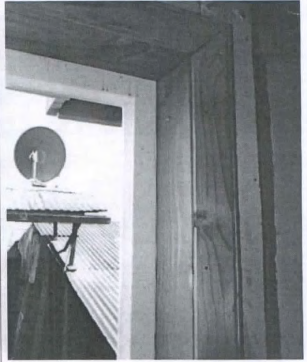
Fotografía N° 19: Marcos de ventana sin sello de silicona.
