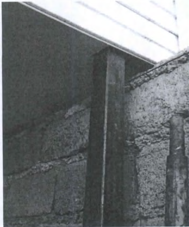
Fotografía N° 14: Estructura metálica con óxido y medianero sin cortafuego.
