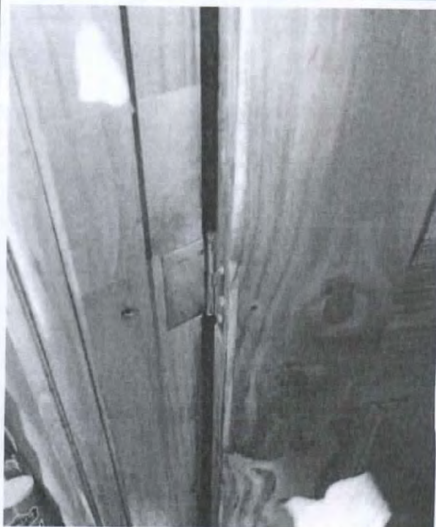
Fotografía N° 23: Bisagras mal instaladas en la puerta de cocina.
