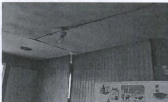
Fotografía N° 84: Falta de molduras.
