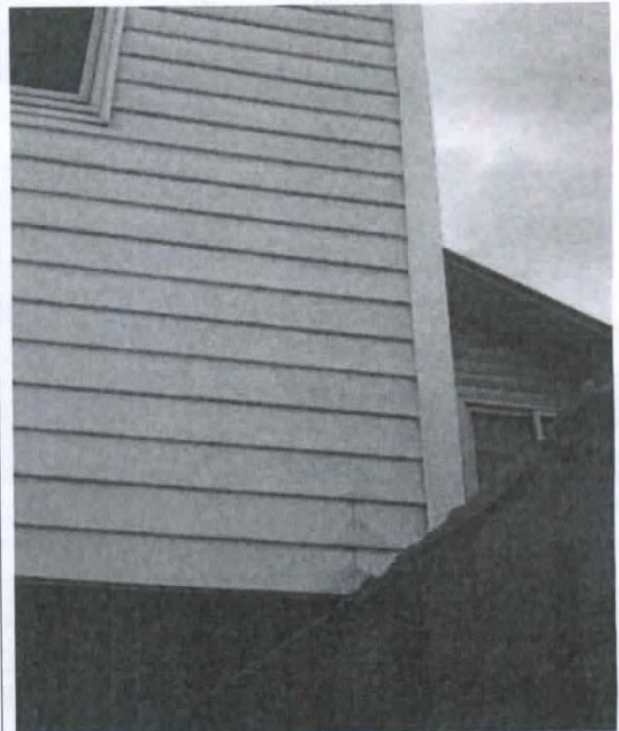
Fotografía N° 15: Medianero sin muro cortafuego.
