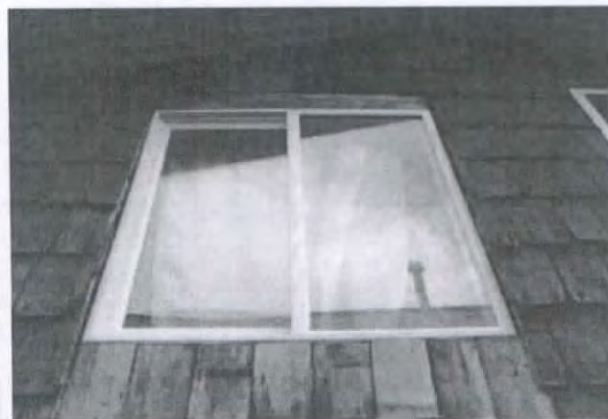
Fotografía N° 2: Marco de la ventana sin sello ni remate con revestimiento de muro, fachada norte.
