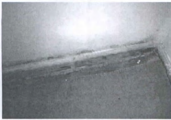
Fotografía N° 26: Hongos y humedad en guardapolvos de la zona ampliada.
