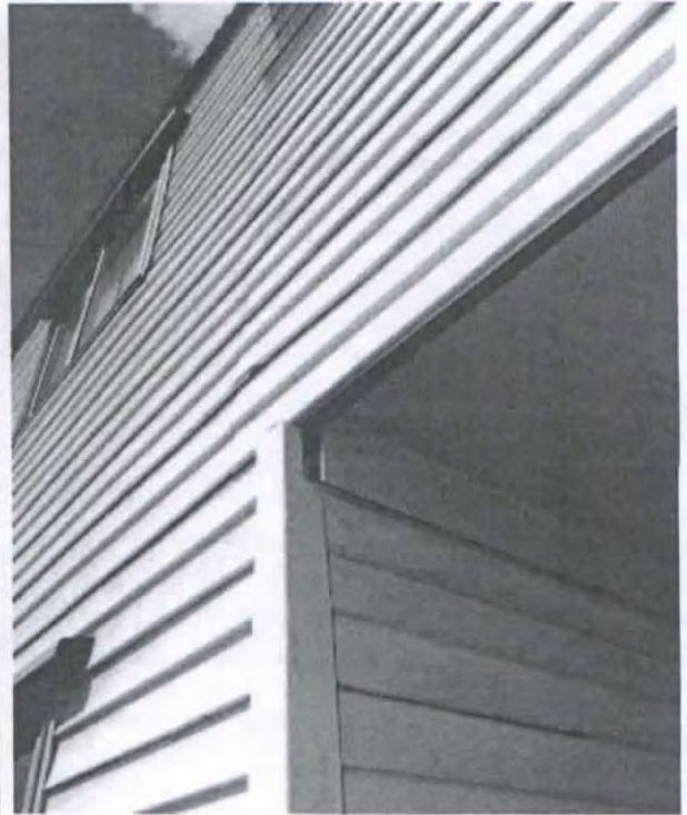
Fotografía N° 35: Bordes sin cubrejunta en los remates del revestimiento exterior.
