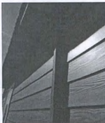
Fotografía N° 82: Falta de sello en junta.
