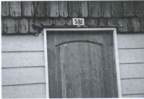
Fotografía N° 5: Marco de la puerta sin sello ni remate con revestimiento de muro, fachada sur.
