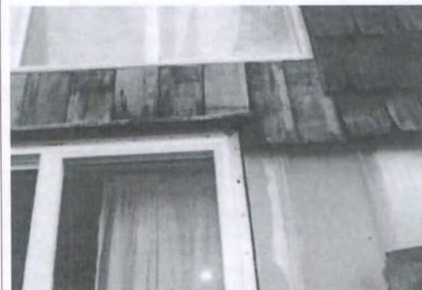
Fotografía N° 4: Marco de la ventana sin sello ni remate con revestimiento de muro, fachada norte.
