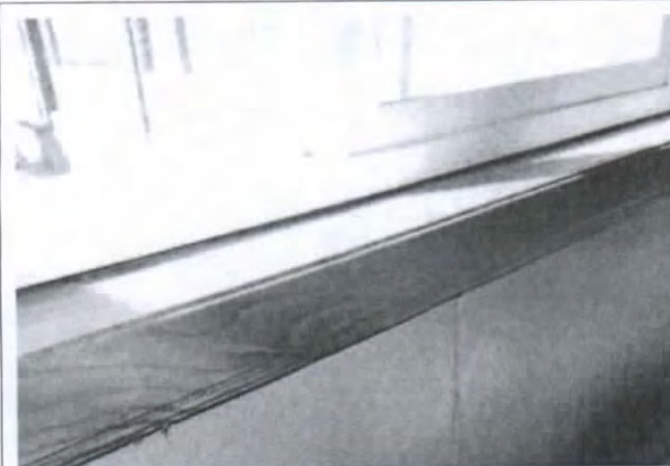
Fotografía N° 16: Marcos de ventana sin sello de silicona.
