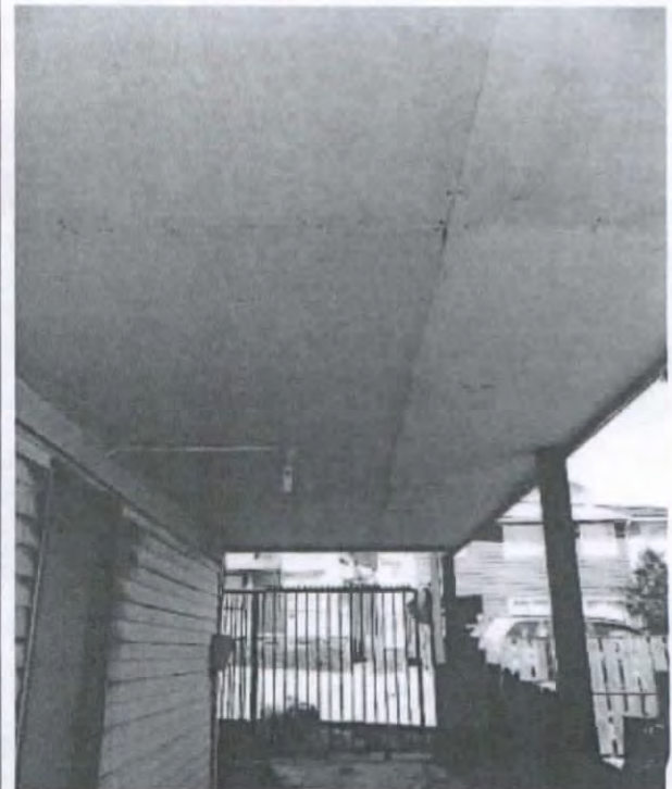
Fotografía N° 37: Bordes sin cubrejunta en los remates del revestimiento exterior.
