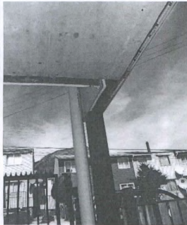
Fotografía N° 36: Bordes sin cubrejunta en los remates del revestimiento exterior.
