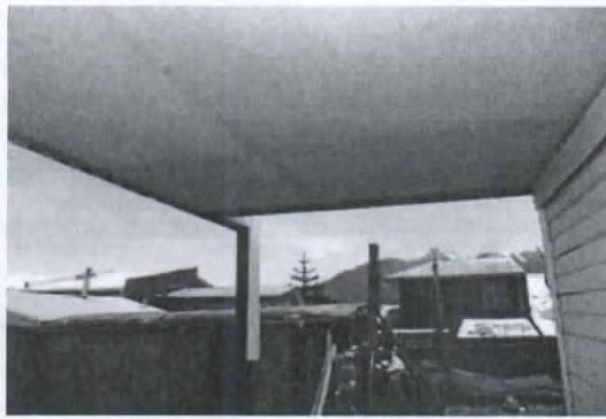
Fotografía N° 38: Bordes sin cubrejunta en los remates del revestimiento exterior.
