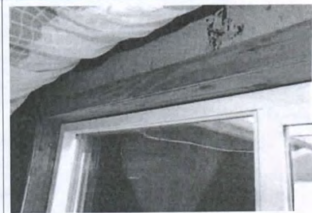
Fotografía N° 17: Marcos de ventana sin sello de silicona.
