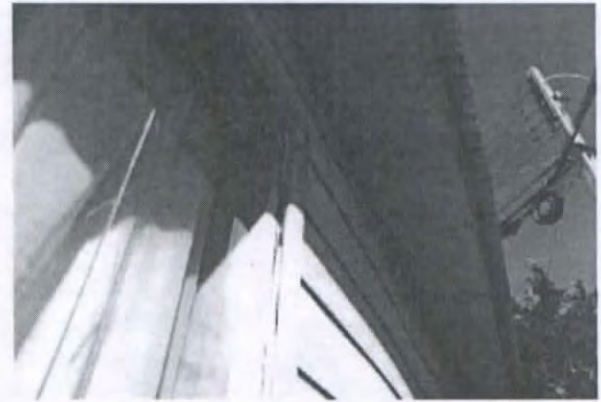
Fotografía N° 79: Falta de sello y terminación deficiente en ventana.
