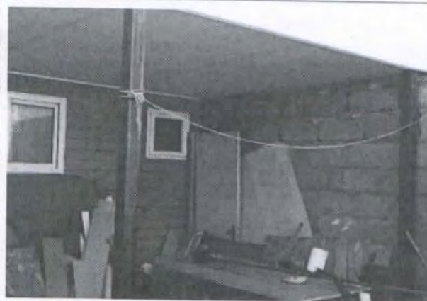
Fotografía N° 13: Estructura metálica con óxido y medianero sin muro cortafuego.
