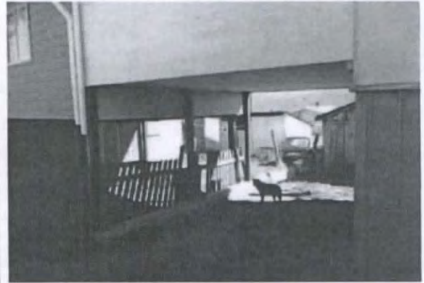
Fotografía N° 51: bajadas de agua cortas
