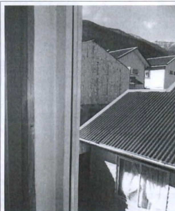
Fotografía N° 66: Ventana de la escalera sin sello entre el vidrio y el marco.
