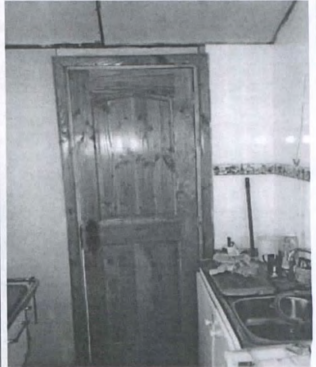
Fotografía N° 21: Excesiva separación de la hoja con el marco de la puerta de cocina.
