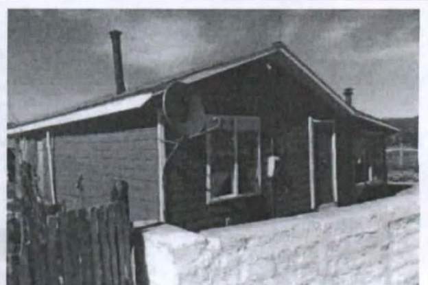
Fotografía N° 49: Ampliación lateral, no incluida en el proyecto.
