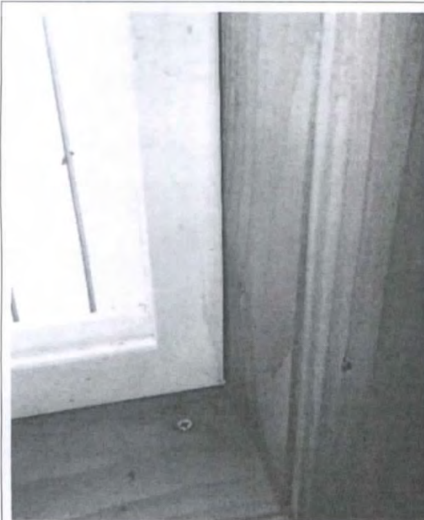
Fotografía N° 18: Marcos de ventana sin sello de silicona.
