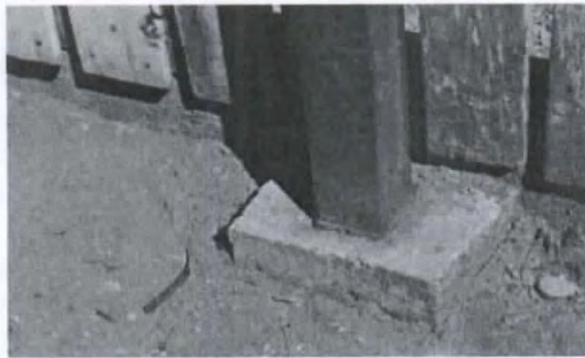
Fotografía N° 74: Pilar con óxido
