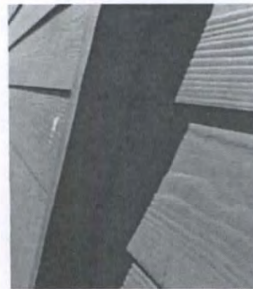
Fotografía N° 83: Falta de sello en Junta
