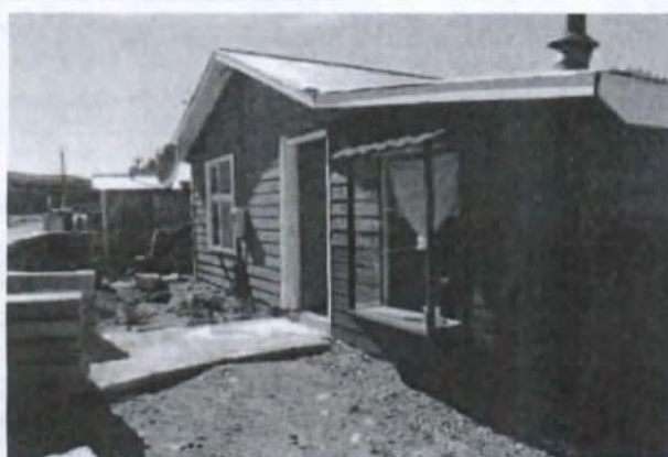
Fotografía N° 48: Ampliación lateral, no incluida en el proyecto.
