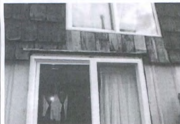
Fotografía N° 3: Marco de la ventana sin sello ni remate con revestimiento de muro, fachada norte.
