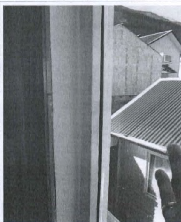
Fotografía N° 67: Ventana de la escalera sin sello entre el vidrio y el marco.
