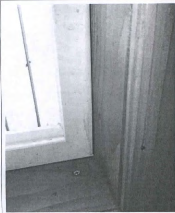
Fotografía N° 18: Marcos de ventana sin sello de silicona.
