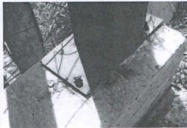
Fotografía N° 52: Tuercas y pernos de anclaje oxidados en fundaciones.
