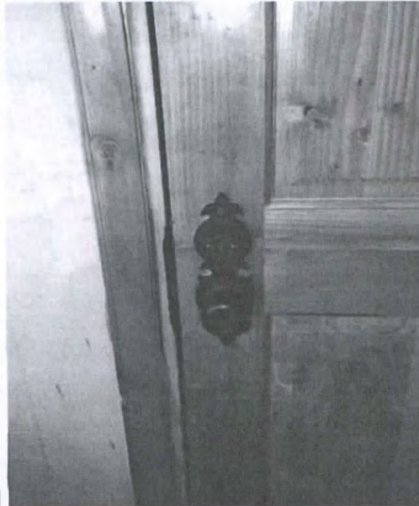
Fotografía N° 20: Cerradura instalada al revés en la puerta de cocina.
