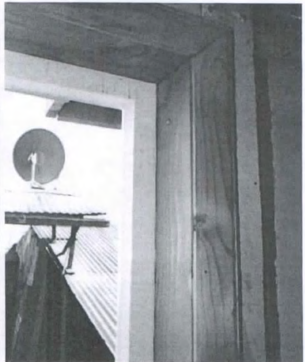
Fotografía N° 19: Marcos de ventana sin sello de silicona.
