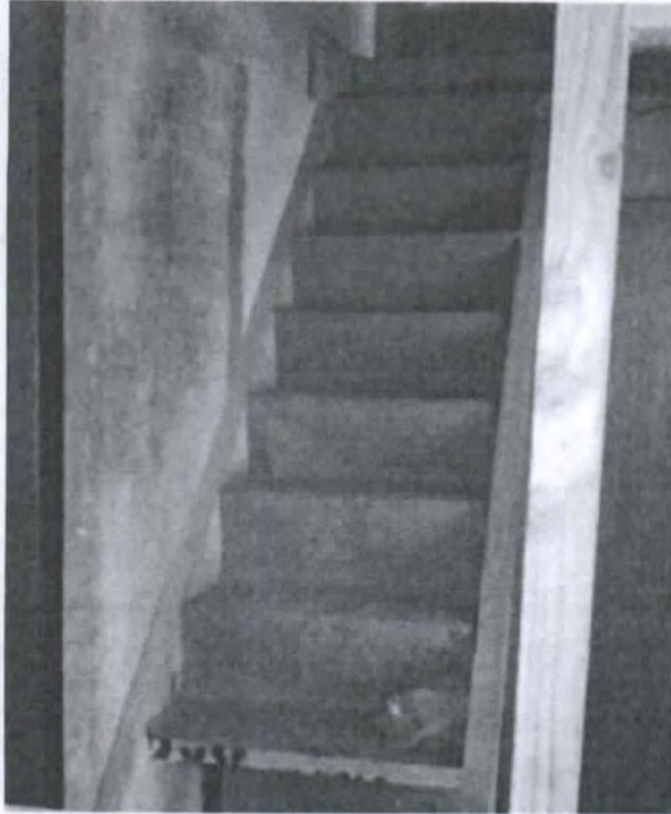
Fotografía N° 46: Escalera interior en ubicación distinta a lo proyectado.
