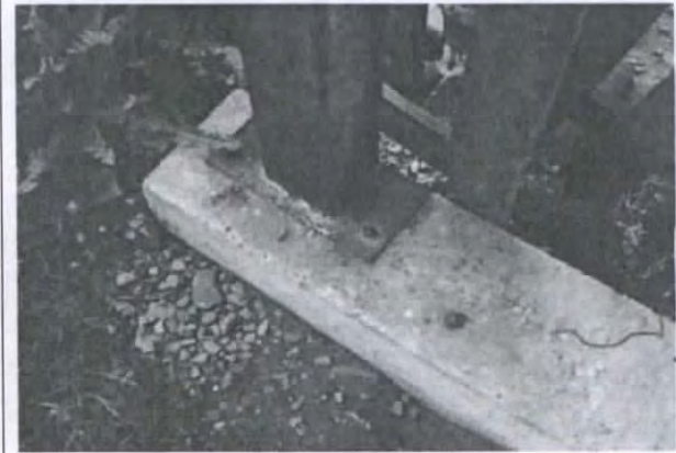
Fotografía N° 53: Tuercas y pernos de anclaje oxidados en fundaciones.
