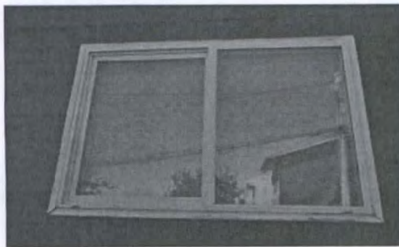
Fotografía N° 80: Ventana con problemas de cierre.
