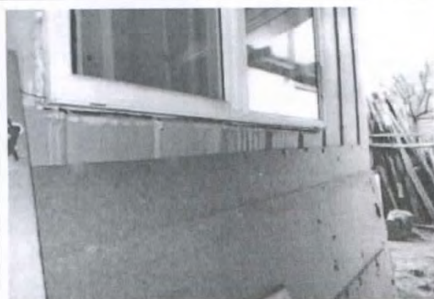
Fotografía N° 1: Marco de la ventana sin sello ni remate con revestimiento de muro, fachada oriente.
