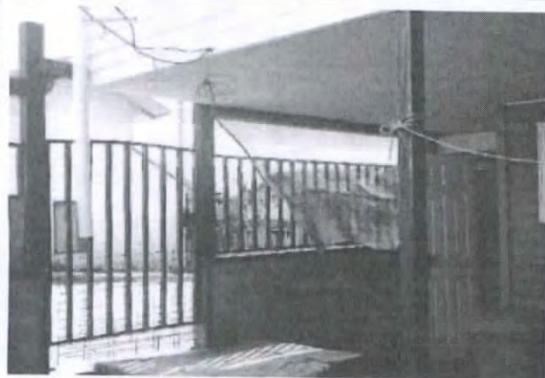
Fotografía N° 12: Bajada de agua corta y estructura metálica con óxido.
