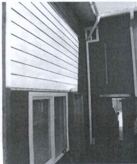
Fotografía N° 24: Revestimiento instalado en fachada lateral de la ampliación posterior no graficada en los planos.
