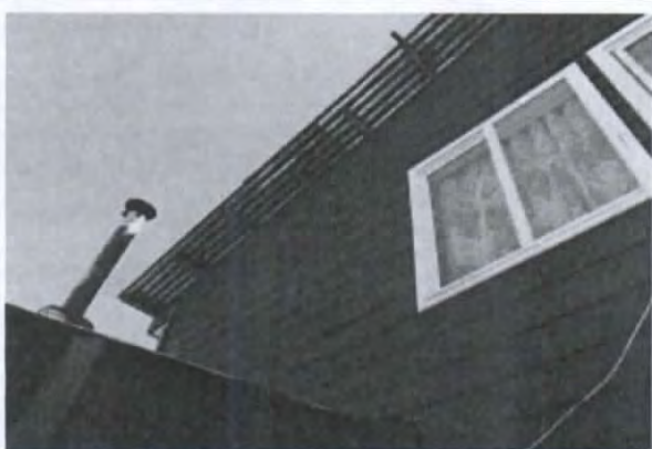
Fotografía N° 86: Ausencia de Aleros
