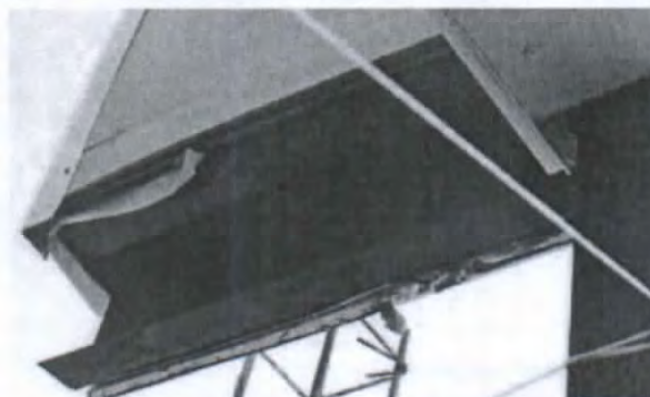
Fotografía N° 76: Yeso Cartón Deteriorado
