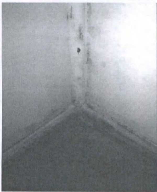
Fotografía N° 28: Hongos y humedad en guardapolvos de la zona ampliada.
