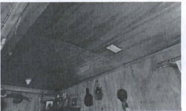
Fotografía N° 77: Daños en cielo de living
