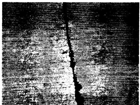
Fotografía N° 18 – 4/03/2015: Desintegración de junta en calle Eusebio Lillo.
