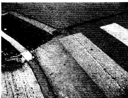
Fotografía N° 9 – 06/03/2015: Falta de sello y desintegración de la junta en calle Magallanes esquina Ramón Freire.
