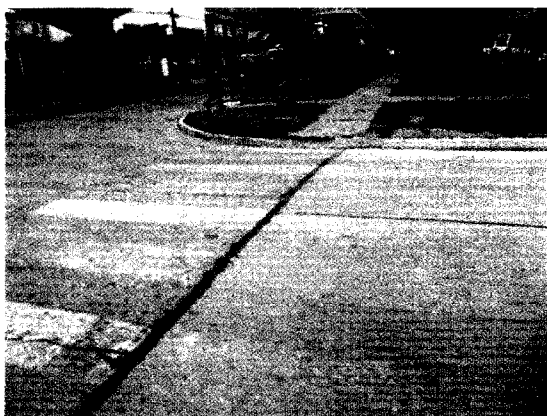
Fotografía N° 11 – 06/03/2015: Falta de sello y desintegración de la junta en calle Presidente Errázuriz esquina Lord Cochrane.
