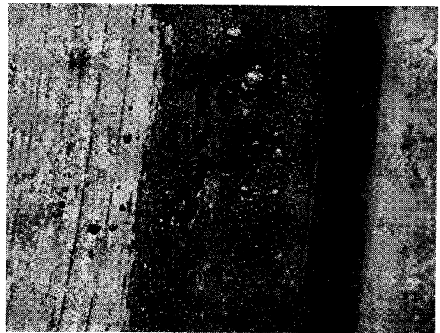
Fotografía N° 12 Lugar: Calle Chilco, entre inicio de calle e intersección calle Amancal. Observación: Separación berma-pavimento
