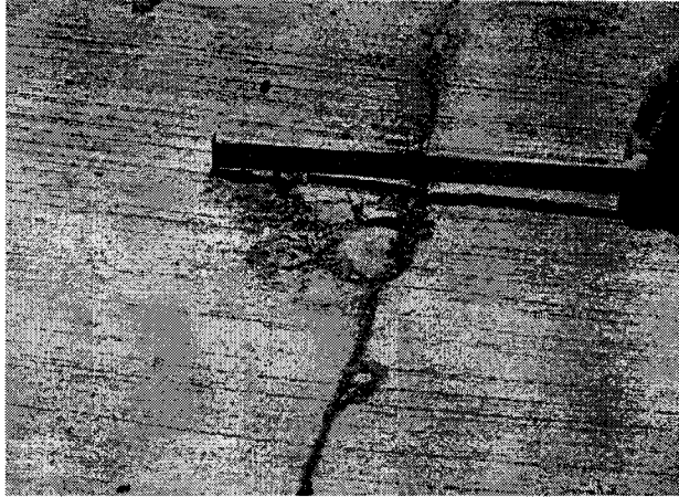
Fotografía N° 1 Lugar: Calle Amancal, intersección calle Chilco. Observación: Junta saltada
