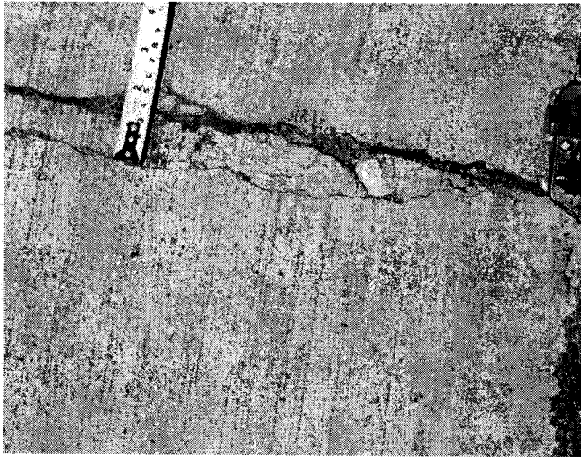
Fotografía N° 7 Lugar: Calle Amancal, entre calle Chilco e intermedia. Observación: Junta saltada
